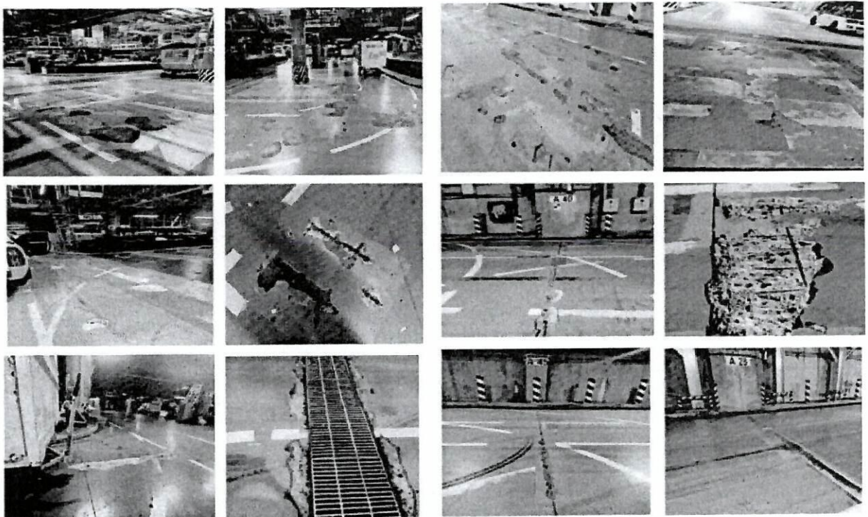
รูปที่ 26 พื้นผิวถนนในพื้นที่ Sorting Area อาคาร MTB ก่อนการซ่อมแซม
