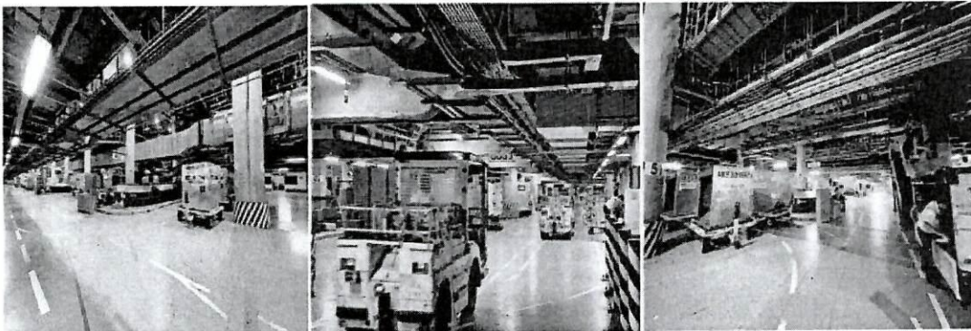
รูปที่ 14 สภาพแวดล้อมและสิ่งอำนวยความสะดวกในพื้นที่ Sorting Area อาคาร MTB
